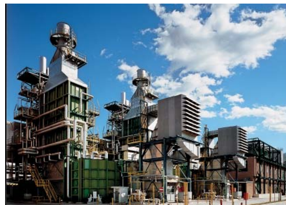
Usine de production, Avezzano
